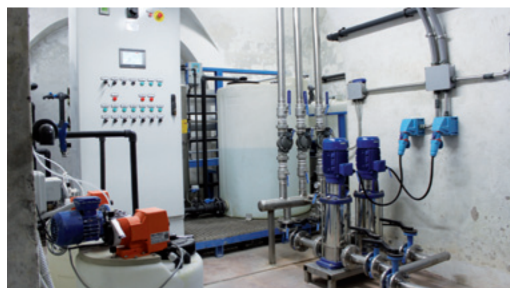
Negli ambienti industriali occorre valutare i possibili aggressivi chimici e meccanici
