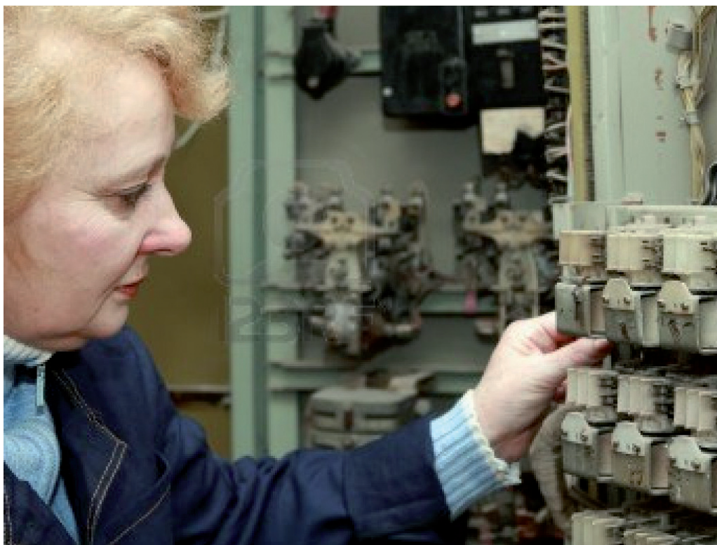
È necessario verificare periodicamente il corretto funzionamento dei relè
