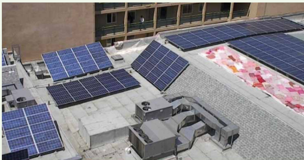
Libertà di collocazione e orientamento dei moduli negli impianti a microinverter
