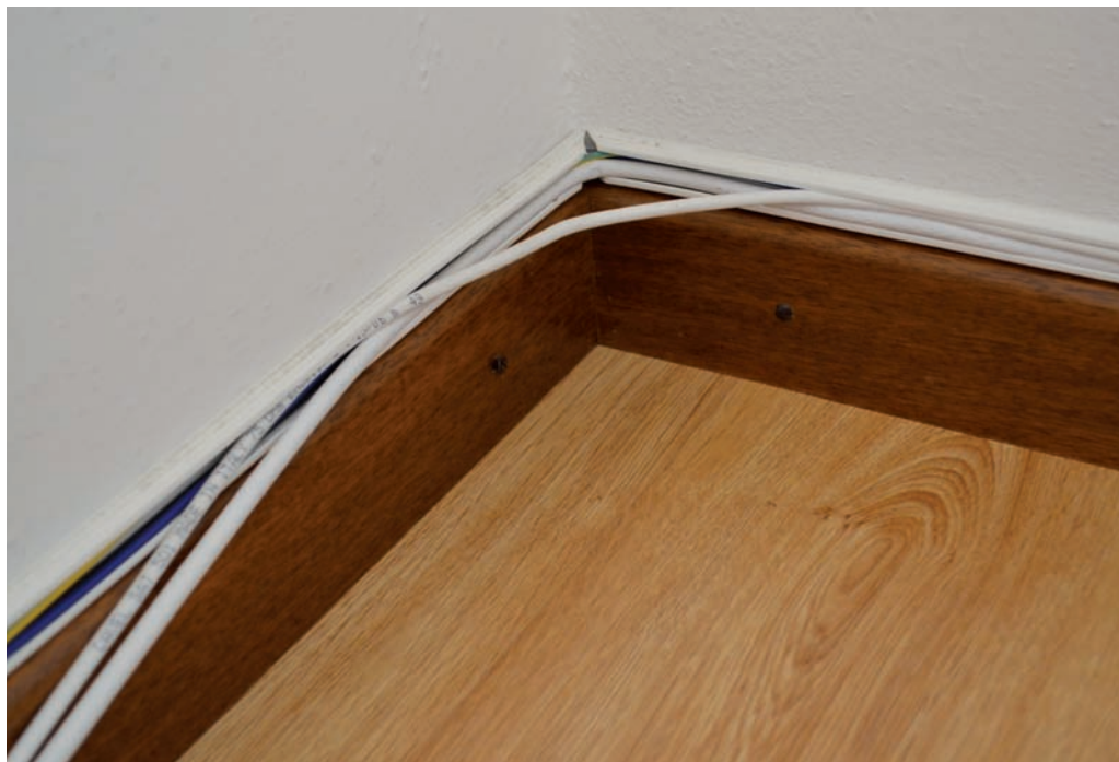
La protezione dei cavi è spesso affidata a canaline di bassa qualità
