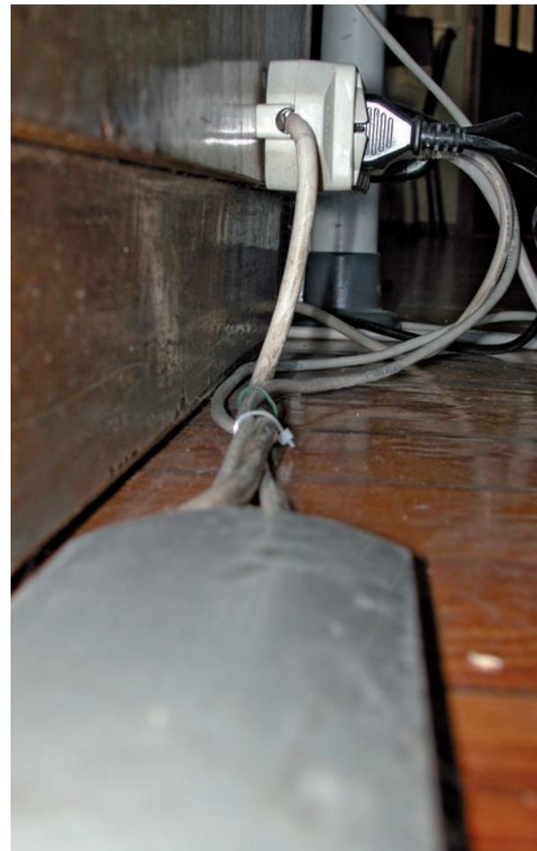
Le condizioni ambientali possono indurre una rapida degradazione
