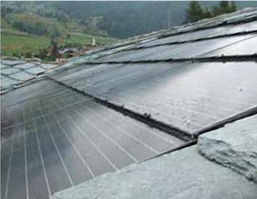
Ubicazione / Site Saint Denis (AO) Potenza / Capacity 6 kW p
