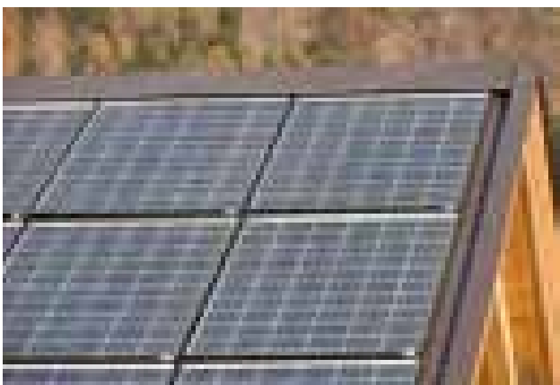
Ubicazione / Site Perca (BZ) Potenza / Capacity 60 kW p
