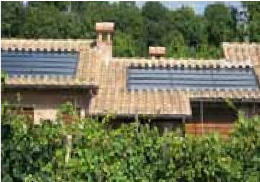
Ubicazione / Site Porchiano (TR) Potenza / Capacity 3 kW p
